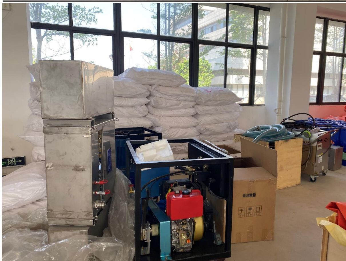
图 7.3-6 检修车间内防溢油设备
