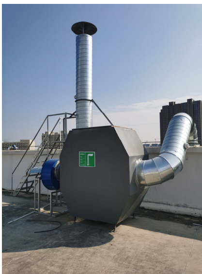
图 4-2 废气污染防治措施照片
