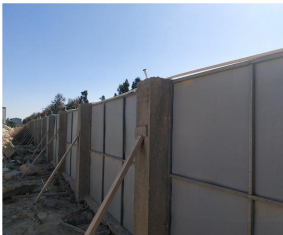
厂界喷淋设施和围挡
