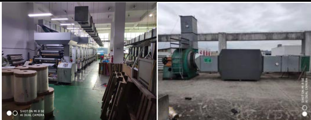
有机废气收集措施有机废气处理设施及排气筒
