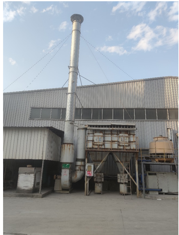
粉尘废气排气筒
