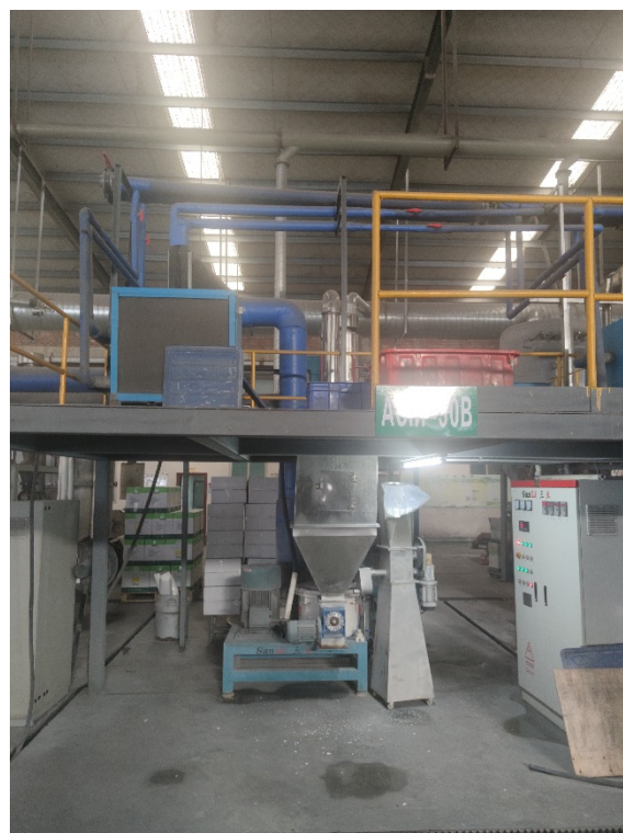
粗碎、粉碎工序密闭引出管道
