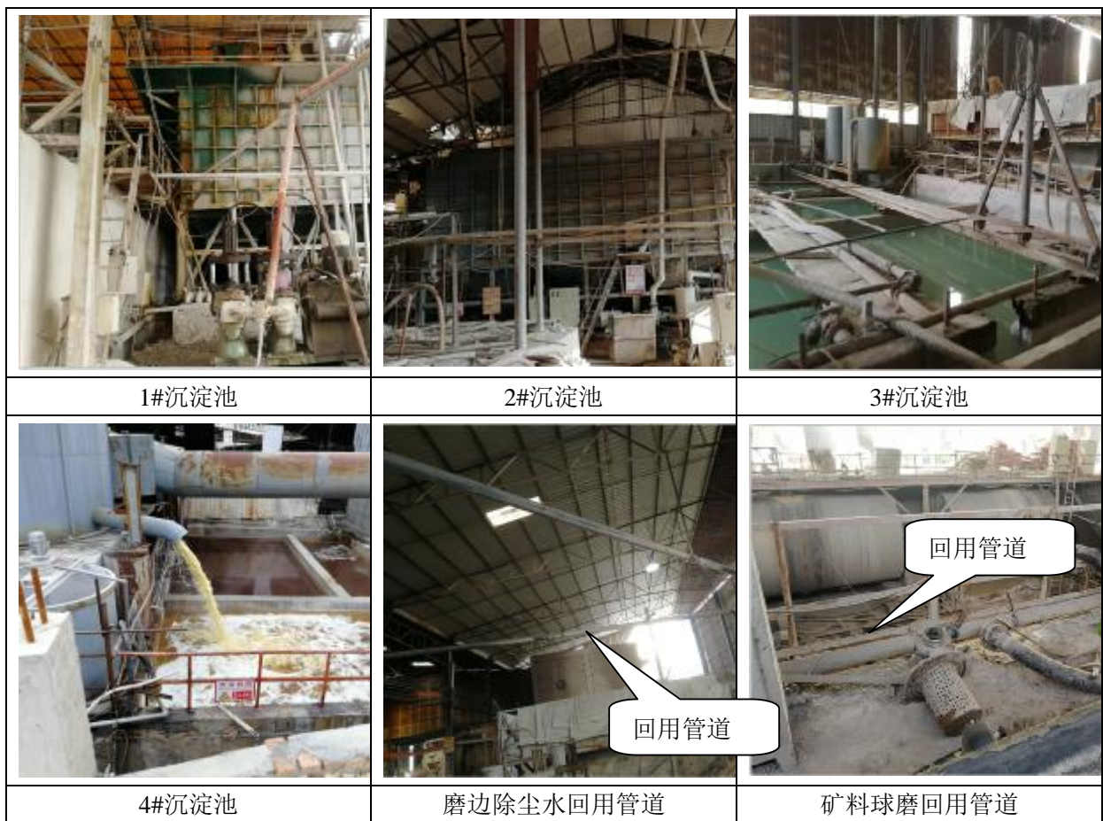
图 4-2 废水治理措施现状照片
