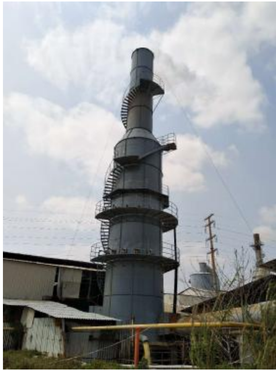
窑炉废气（碱液喷淋塔）
