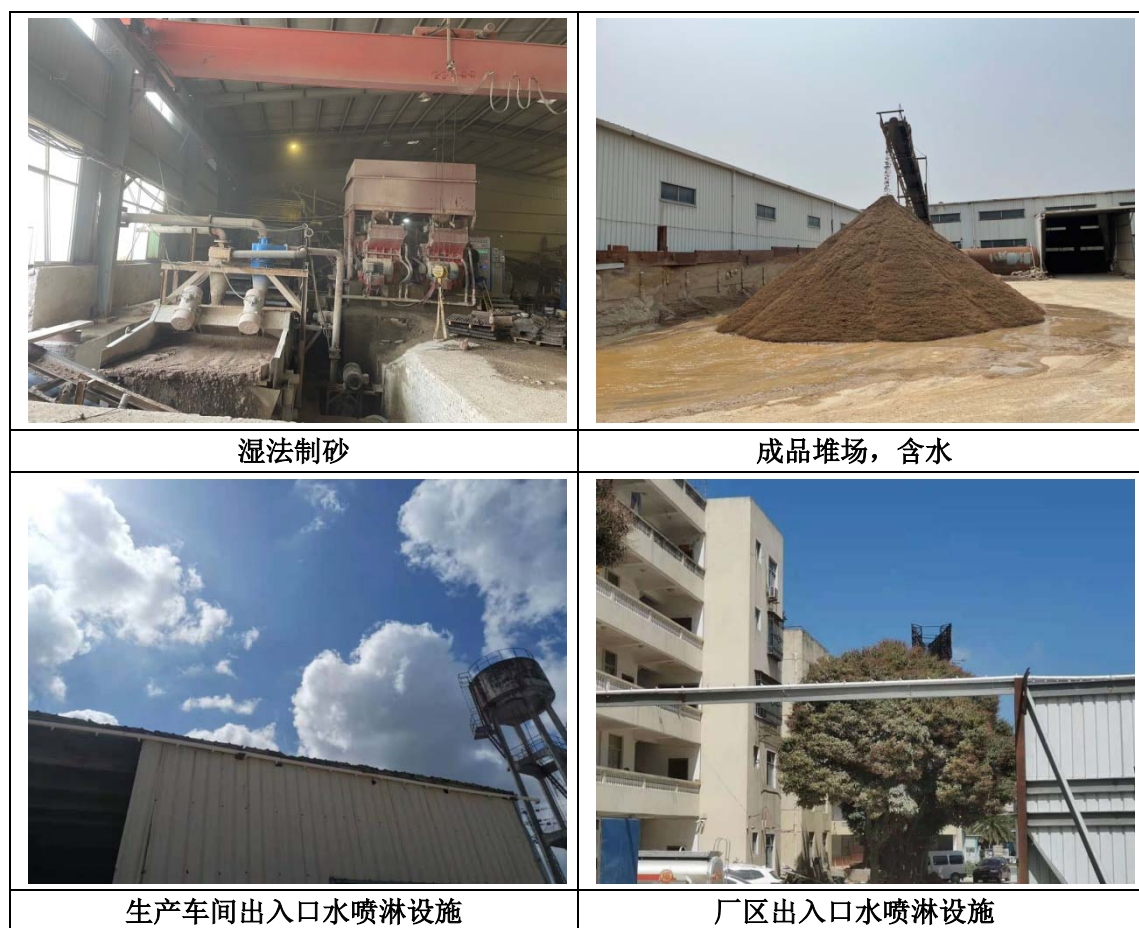
图 4.1-3 废气处理设施照片
