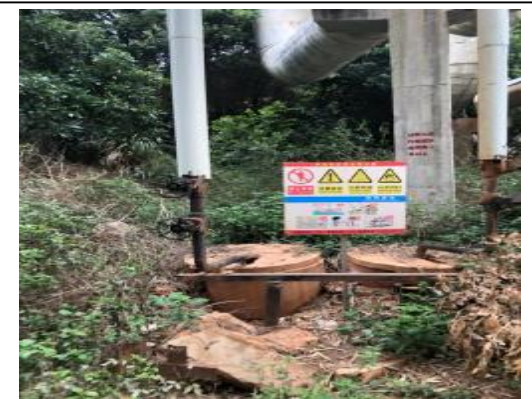
图片 7 冷凝水收集、警示牌
