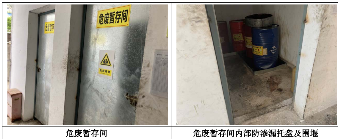
图 4.1-4 固体废物暂存设施照片
