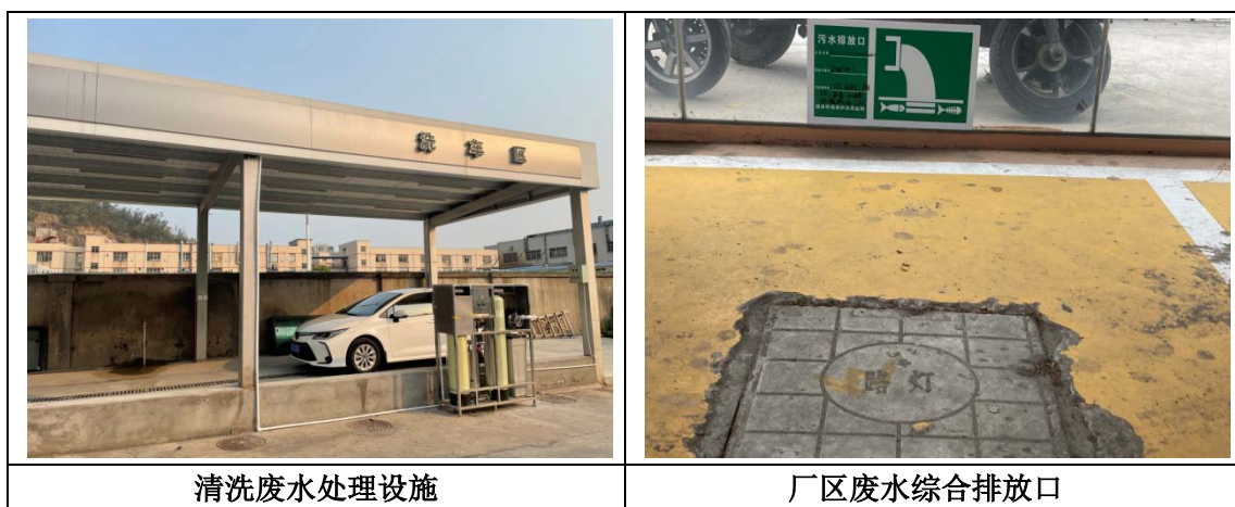
图 4.1-2 废水处理设施照片
