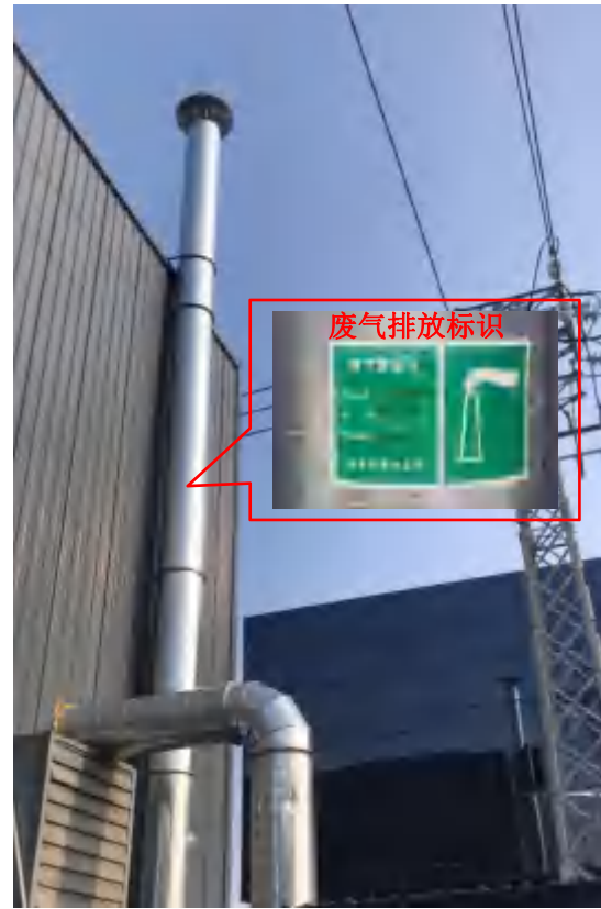
15m 高排气筒
