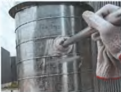
吹膜废气进口
