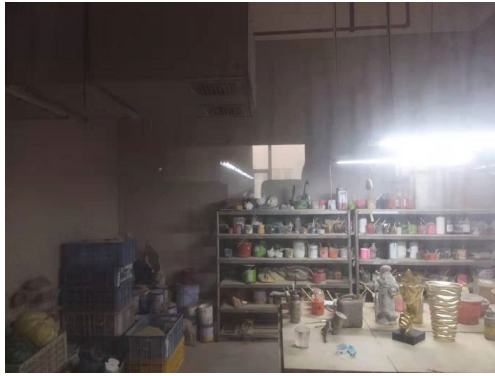
调漆间废气收集管道
