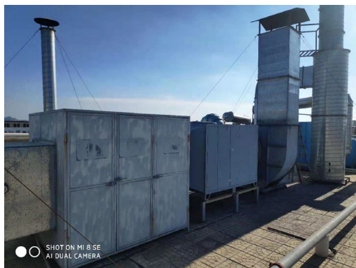
有机废气处理设施-活性炭吸附箱
