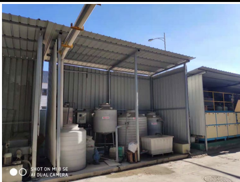
图 4-1 废水污染防治措施照片
