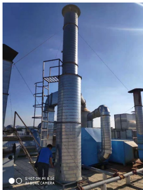
粉尘废气排气筒
