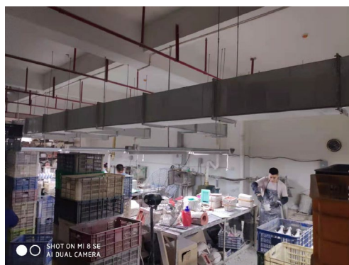
成型间废气收集管道
