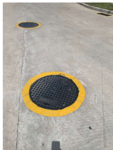
市政污水排放口
