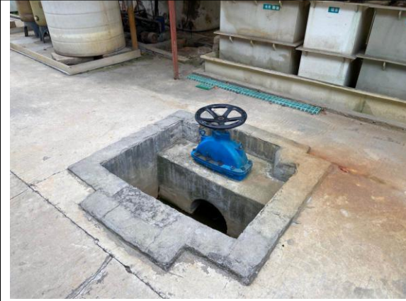
先锋 7-8# 厂房雨水排放口应急阀门
