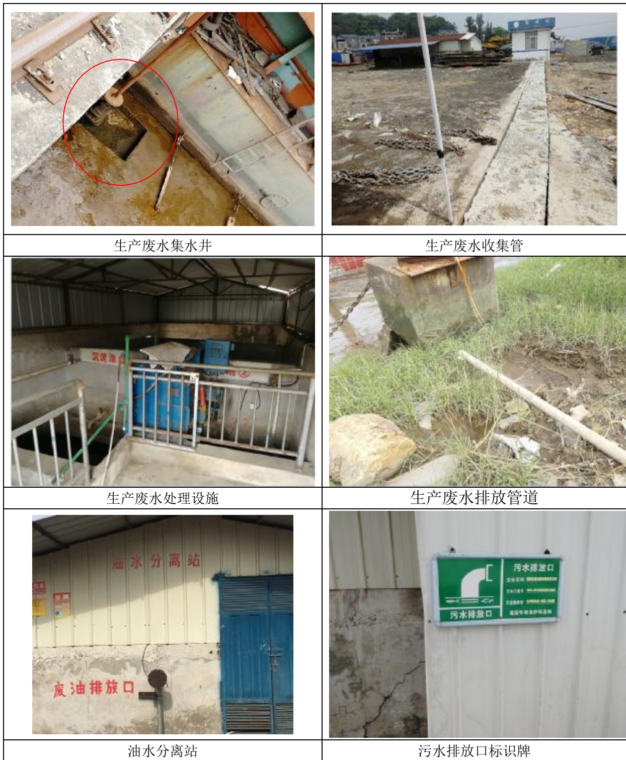
图 4-2 废水处理设施现状照片
