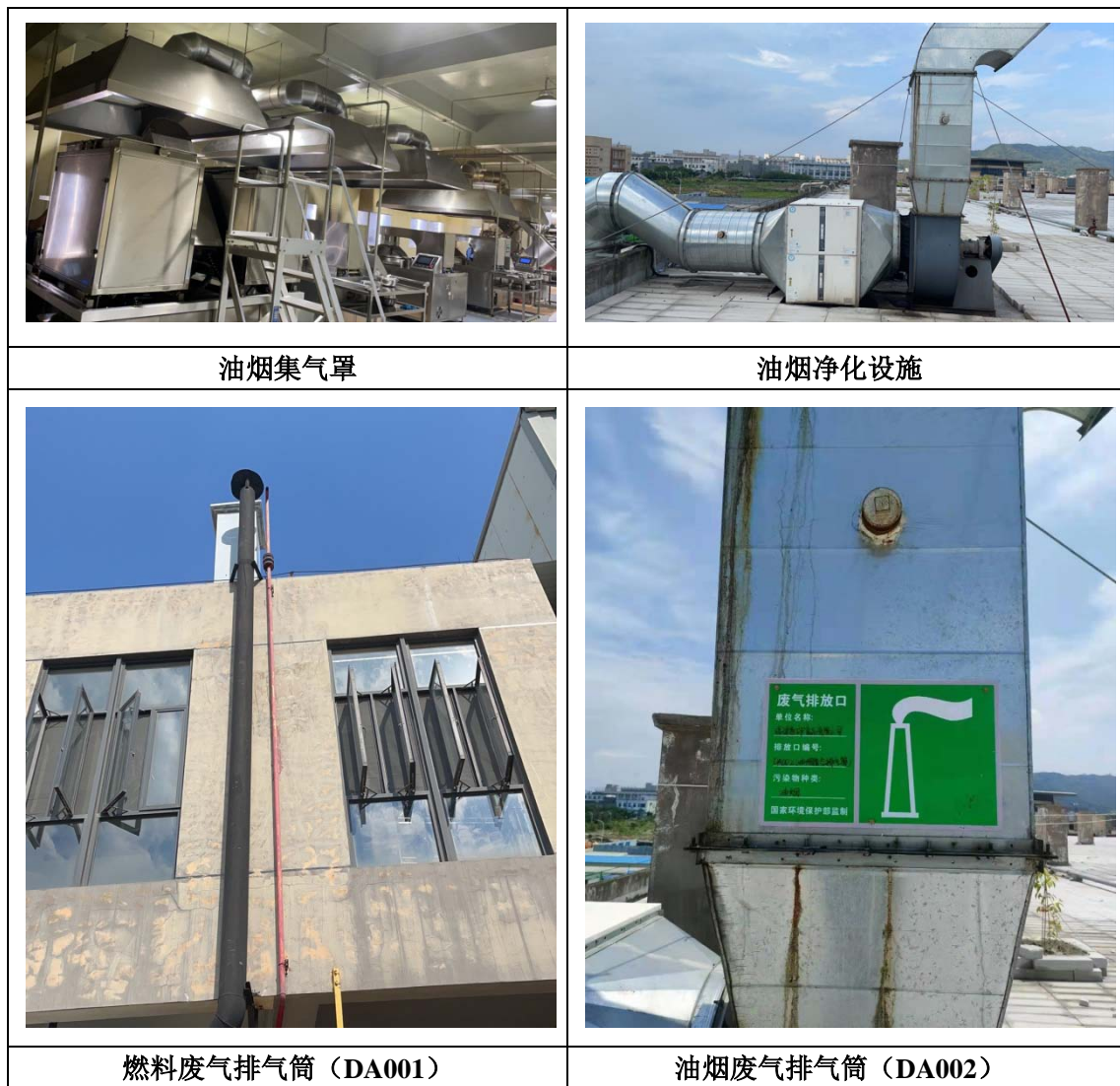
图 4.1-2 废气处理设施照片
