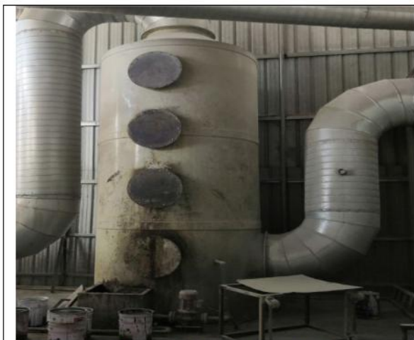
扩建前已配套的漆雾喷淋塔
