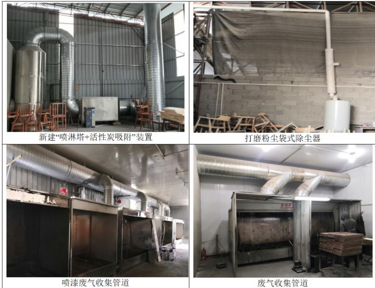
图 4.1-2 项目各废气治理设施照片
