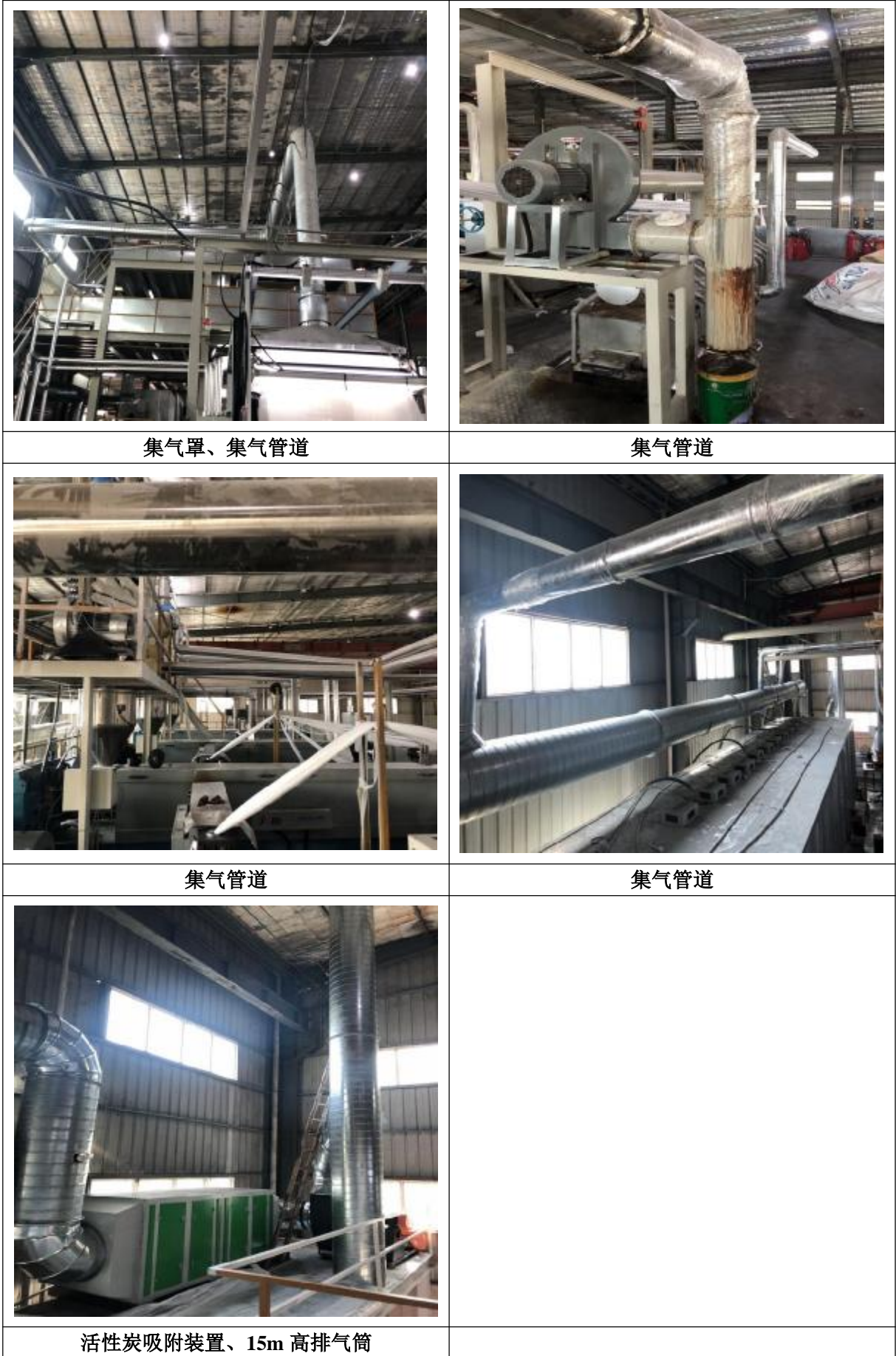
图 4-3 项目废气处理设施现场照片
