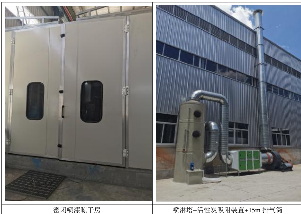
图 4-4 废气治理措施现状照片
