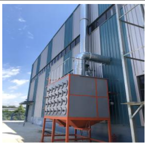
滤芯布袋除尘器+15m 排气筒（◎3#）
