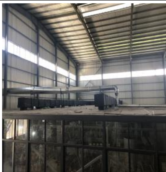
制壳、制蜡废气收集管道
