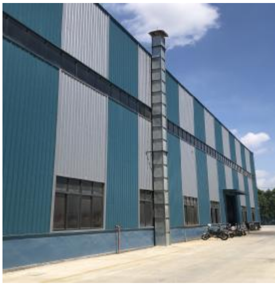
喷漆废气排气筒（15m）（◎1#）
