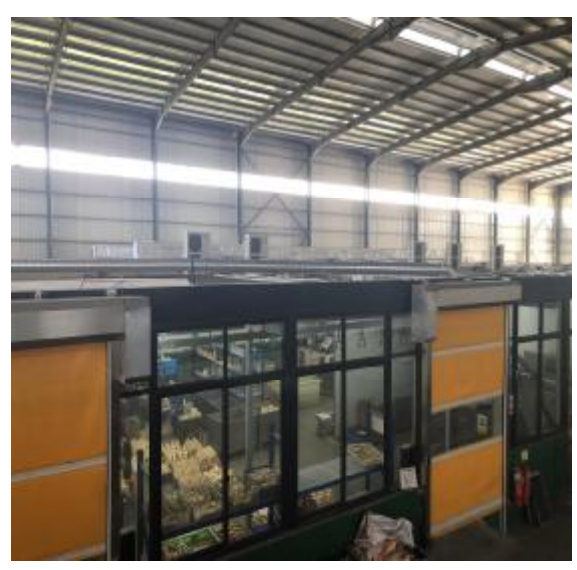
制蜡废气收集管道
