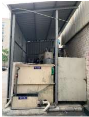
污水处理设施
