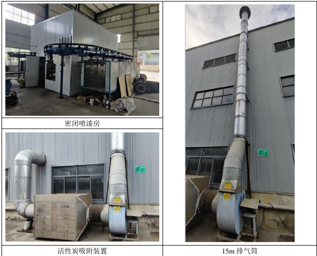
图 4-3 废气治理措施现状照片
