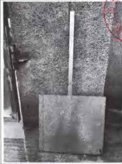
雨水排放口挡板
