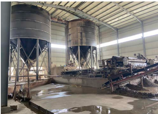
废水沉淀设施
