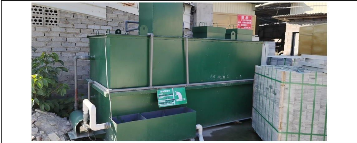
图 4-3、厂区生活污水处理设施照片
