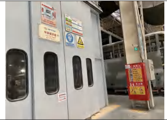
涂装车间灭火器
