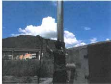
G3 4#排气筒出口
