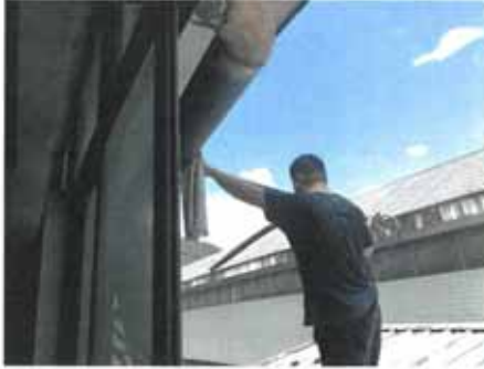
G1 2#排气筒出口
