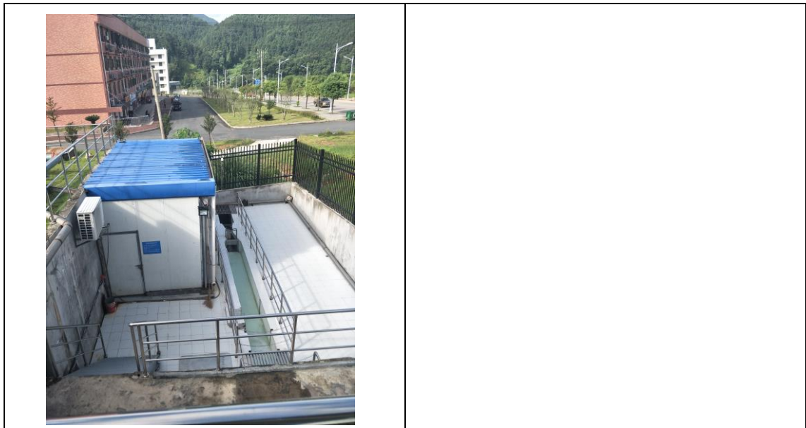
图 4.2-4 生产废水在线监测设施现场情况
