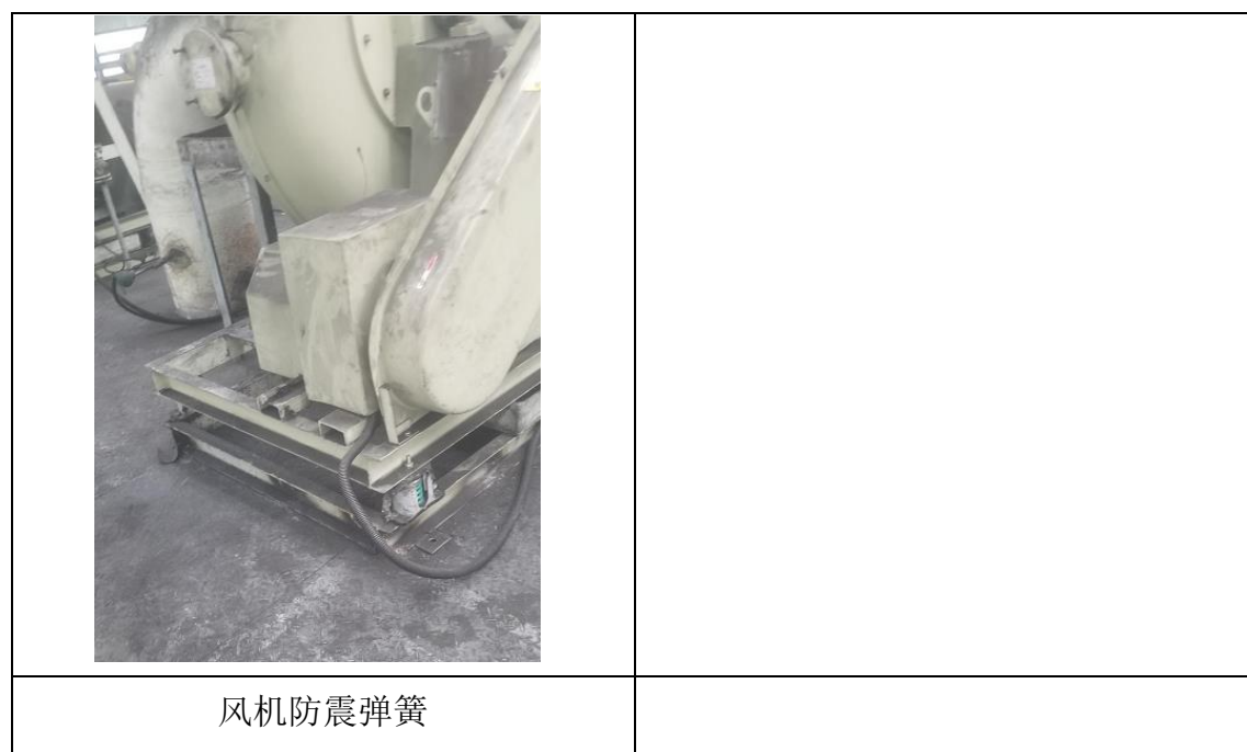
图 4.1-6 设备噪声治理设施现场情况
