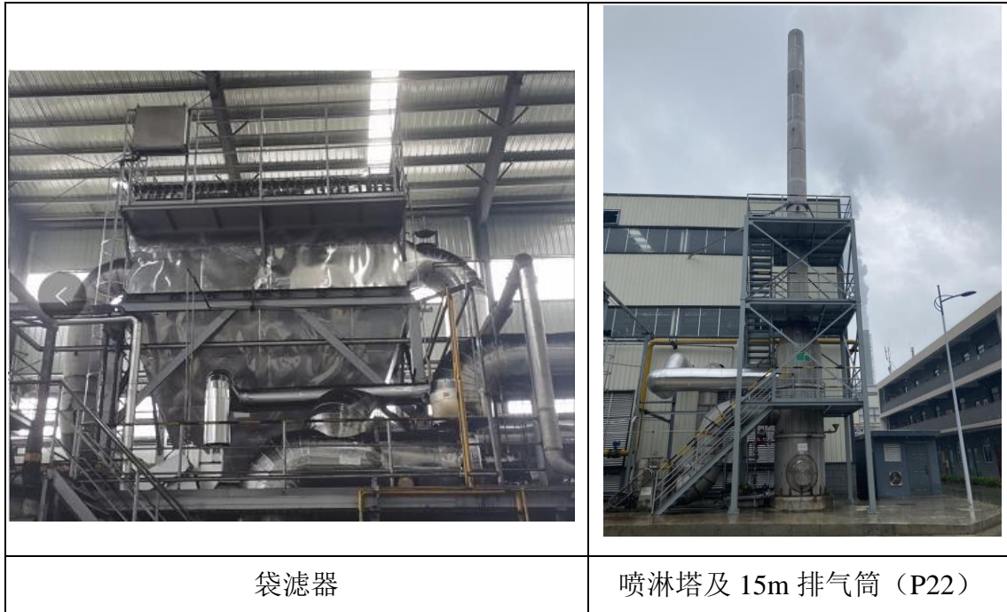
图 4.1-4 研发炭成品烘干废气治理设施现场情况
