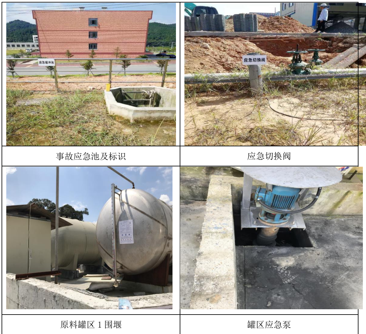
图 4.2-1 风险防控设施现场情况
