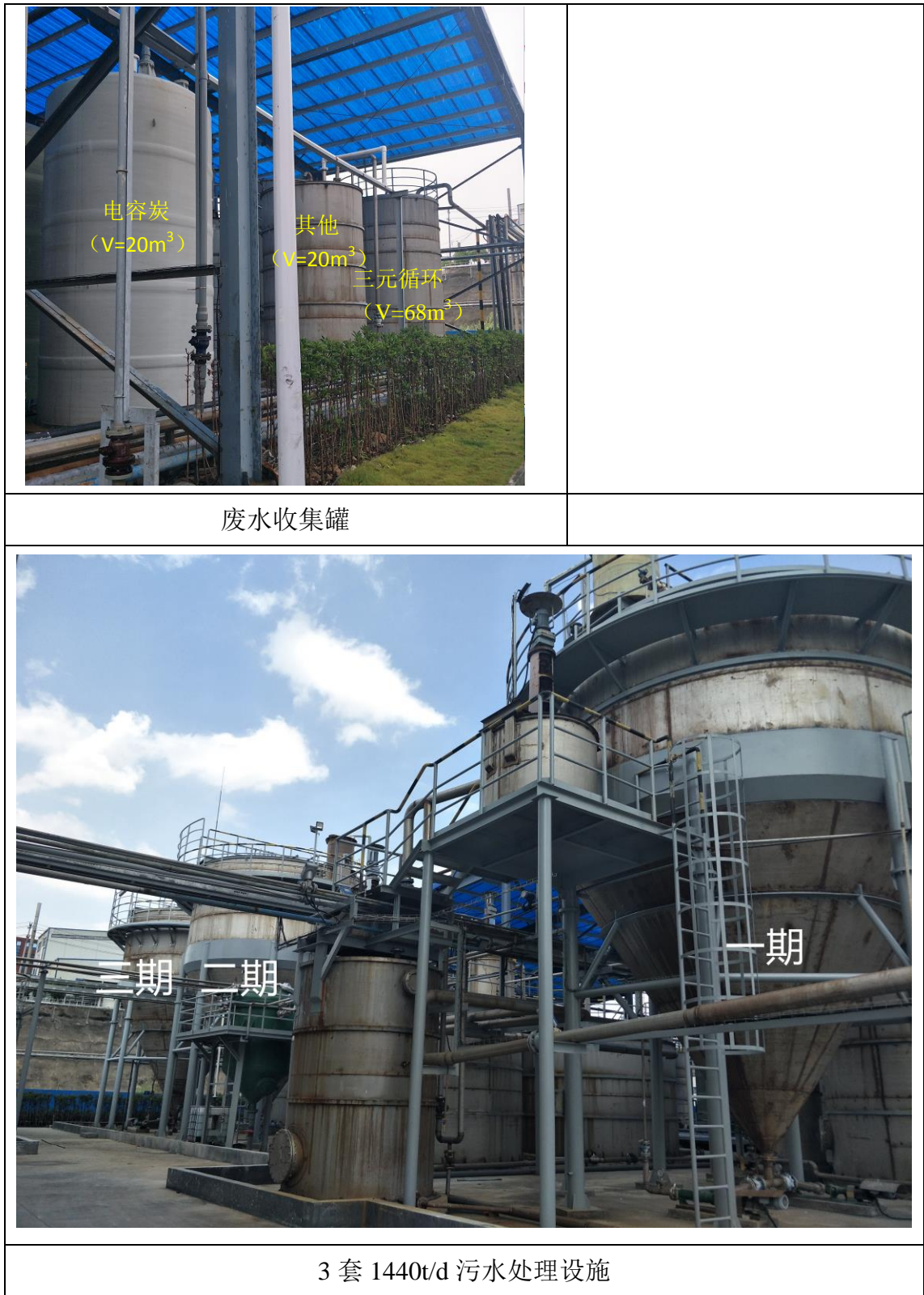
图 4.1-2 厂区污水处理设施现场情况
