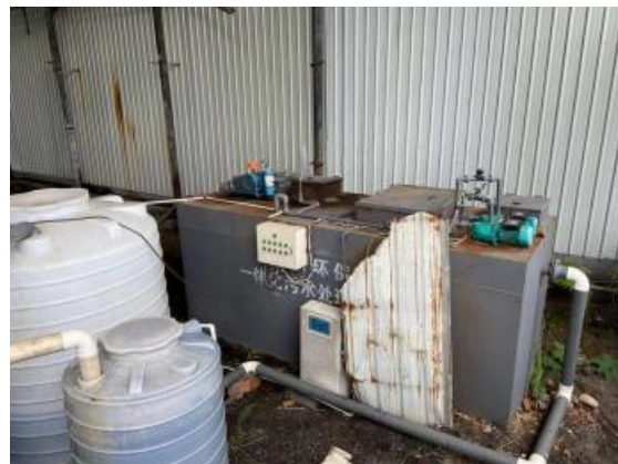
A/O生化+曝气生物滤池+MBR膜
