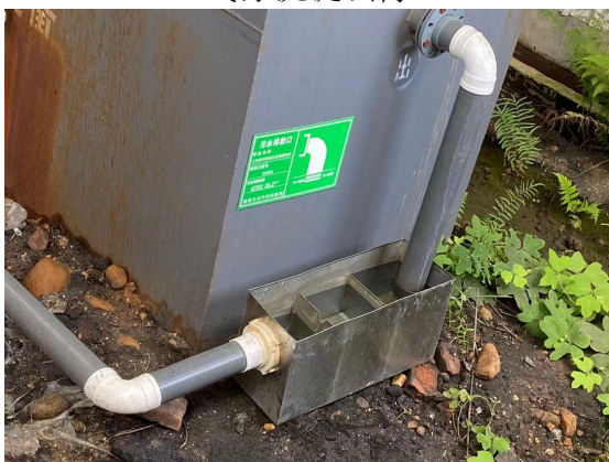
排放口标识牌
