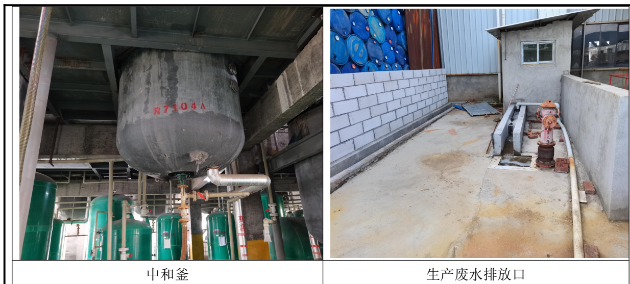
图 3-1 废水处理设施现状图
