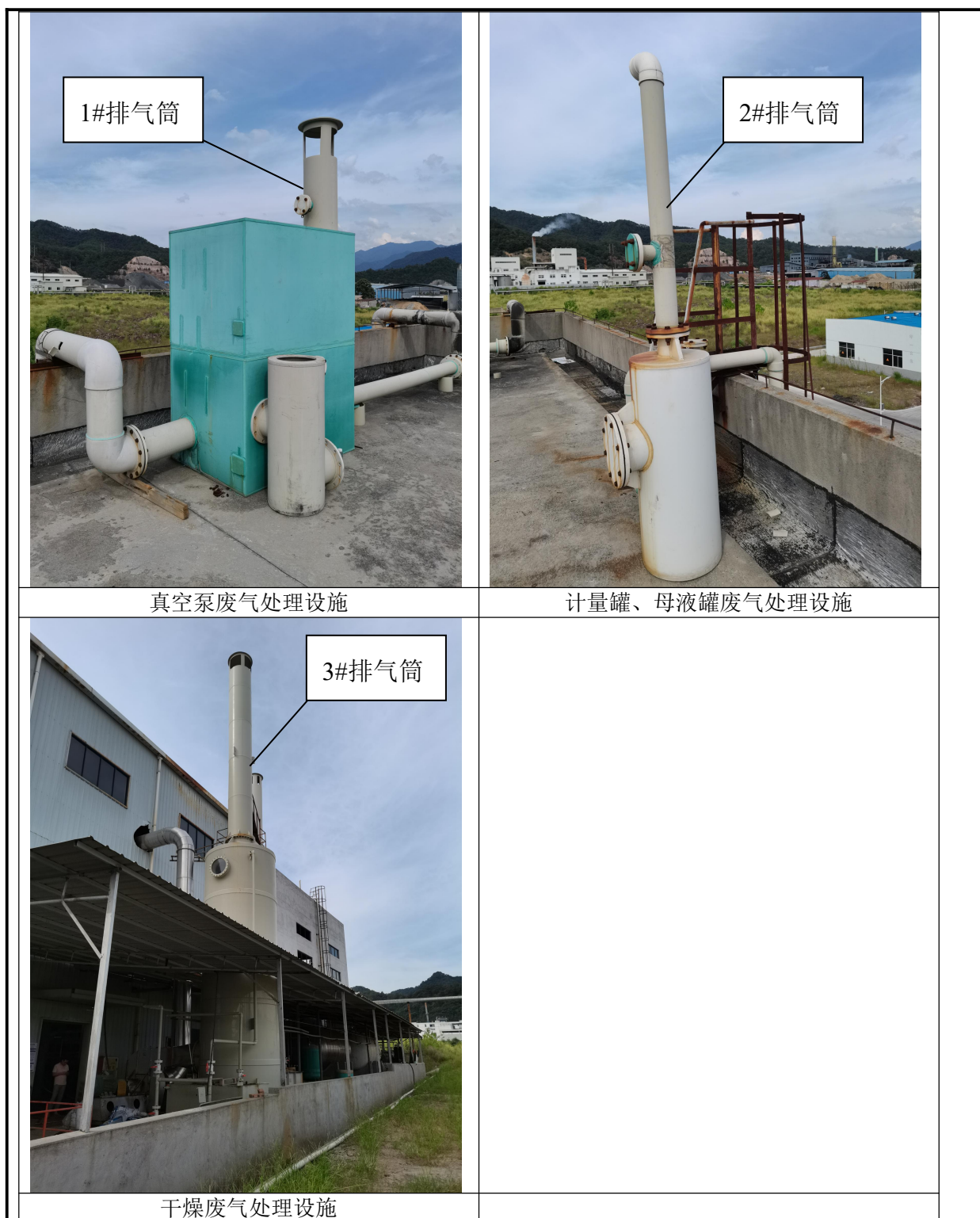
图 3-2 废气处理设施现状图
