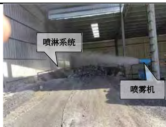
进料口喷淋设施
