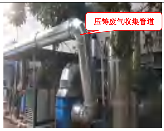
压铸废气收集管道
