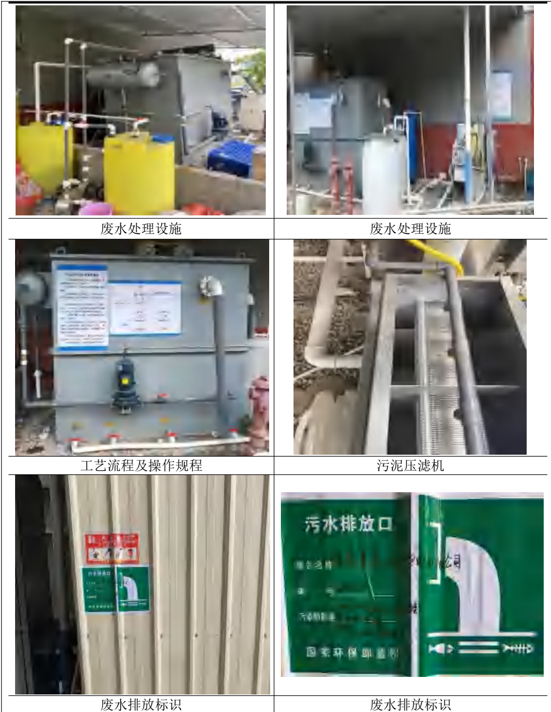
图3.1-2 相关废水处理设施照片
