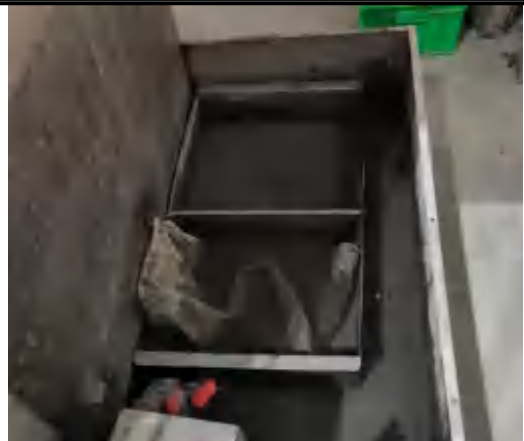
水帘抛光机沉淀池
