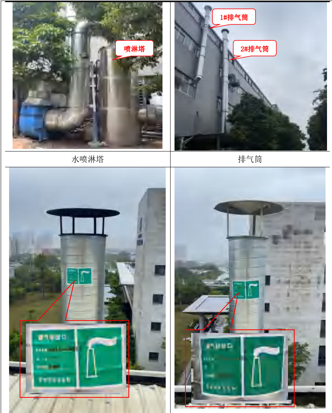
图3.1-8 相关废气处理设施照片
