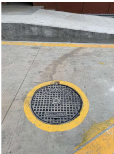
市政雨水排放口
