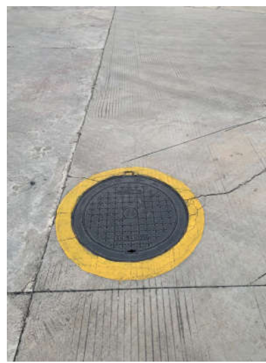
市政污水排放口
