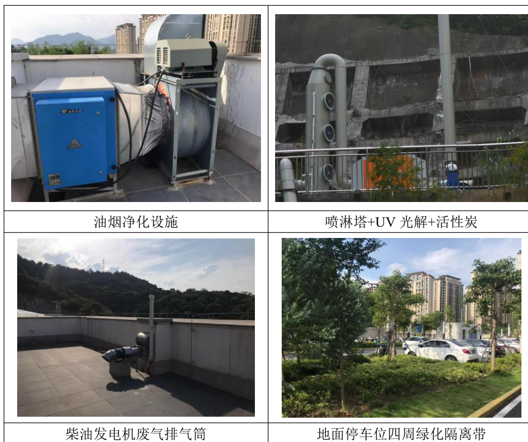
图 5-4、废气处理设施照片
