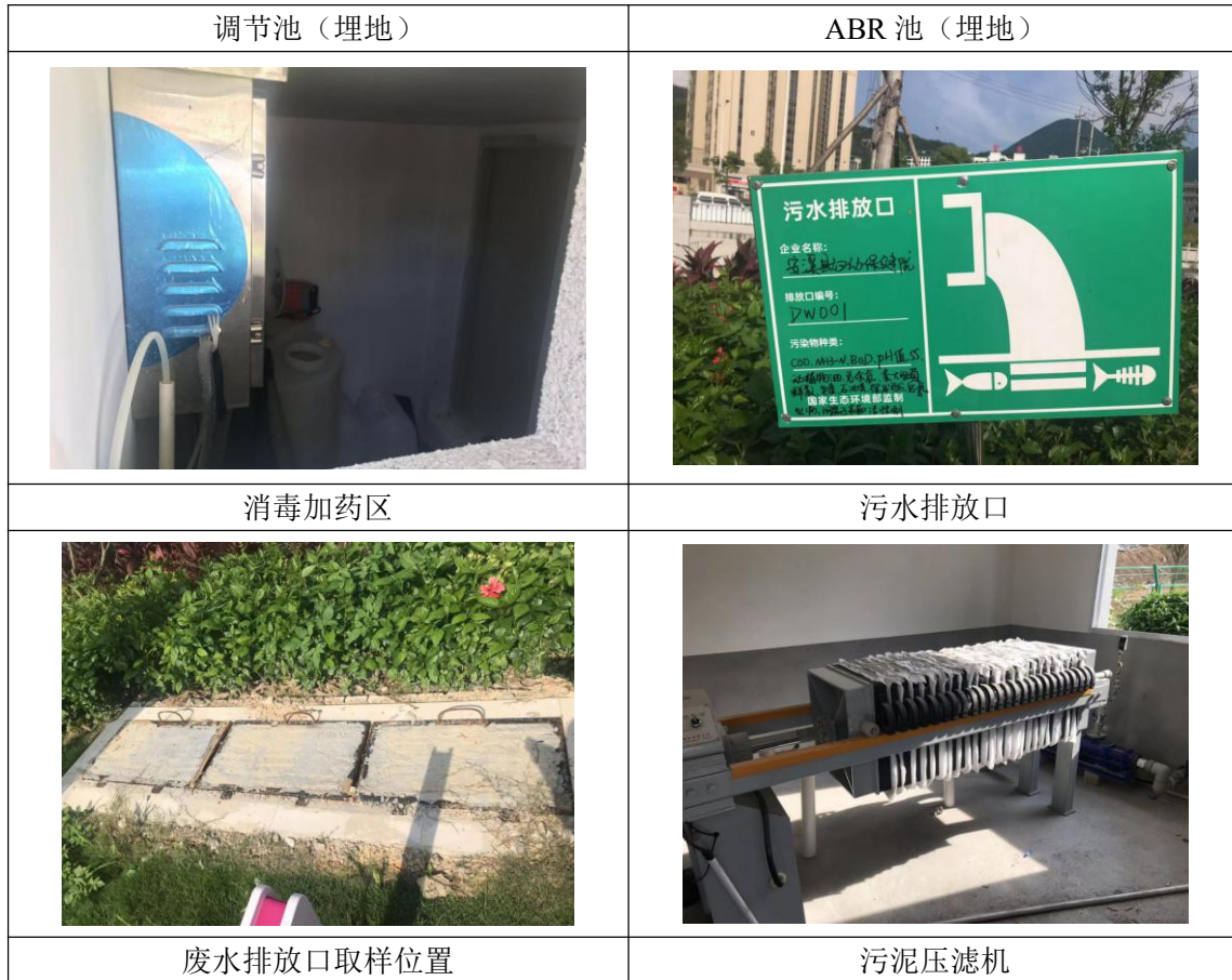
图 5-2、废水处理设施照片
