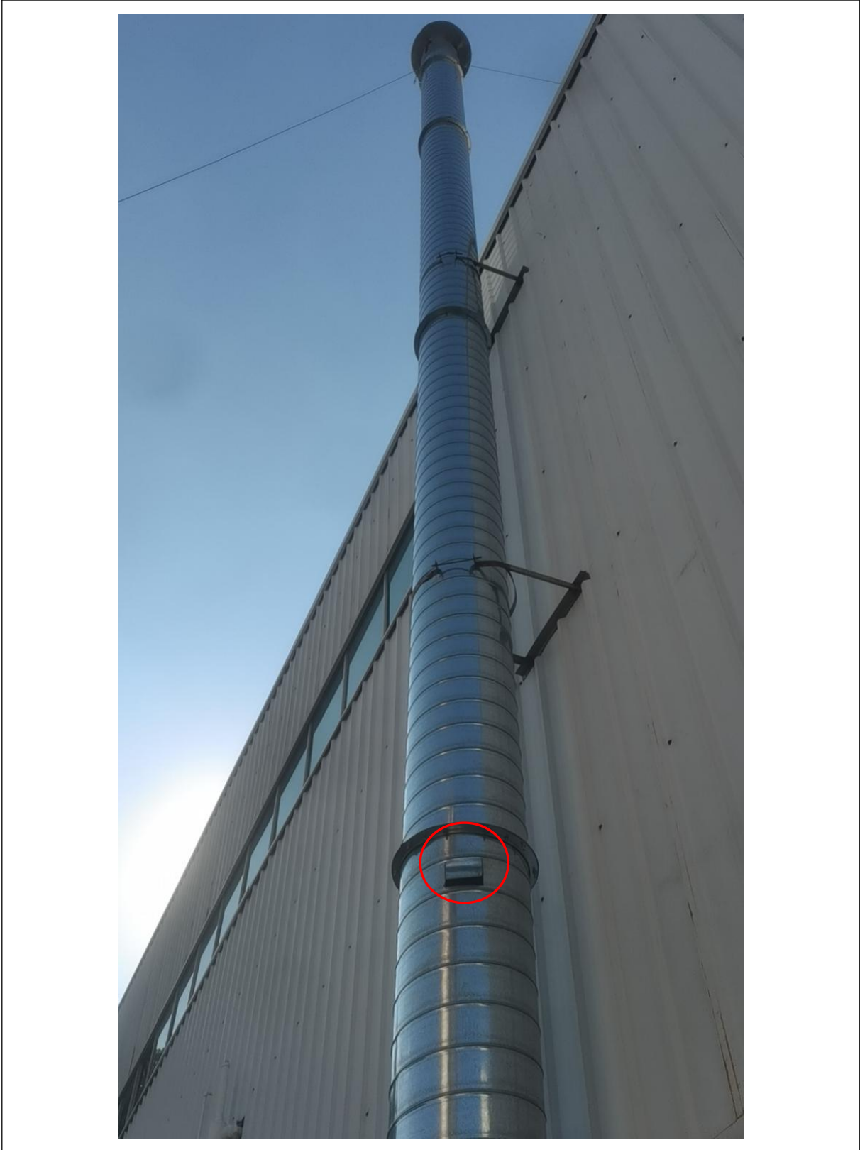
图 4-6 喷漆及晾干废气排气筒监测孔
