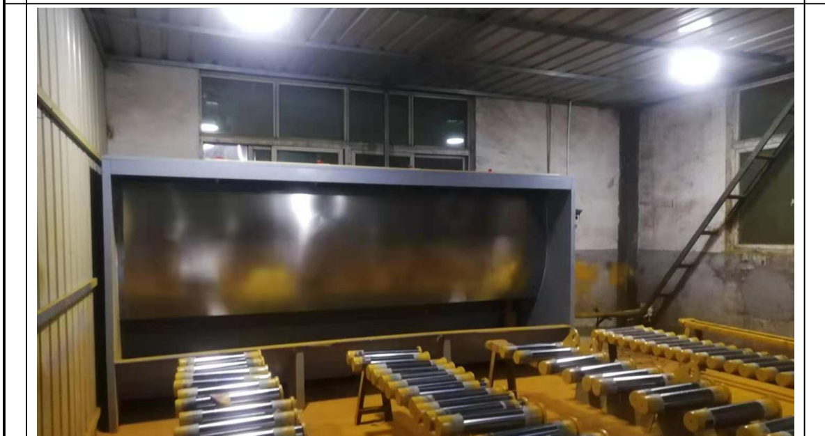
图片 2 喷漆及晾干废气处理设施-水帘柜
