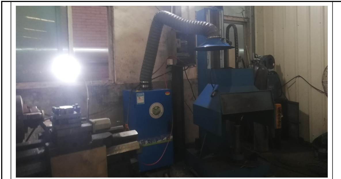
图片 1 焊接烟尘处理设施
