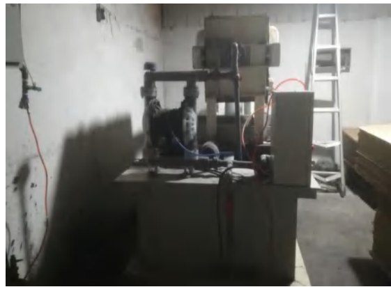
废水处理设施
