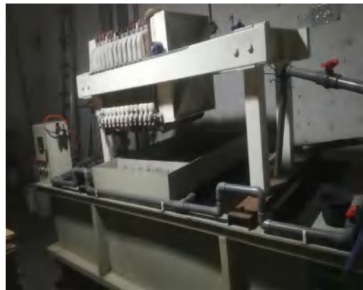
废水处理设施
