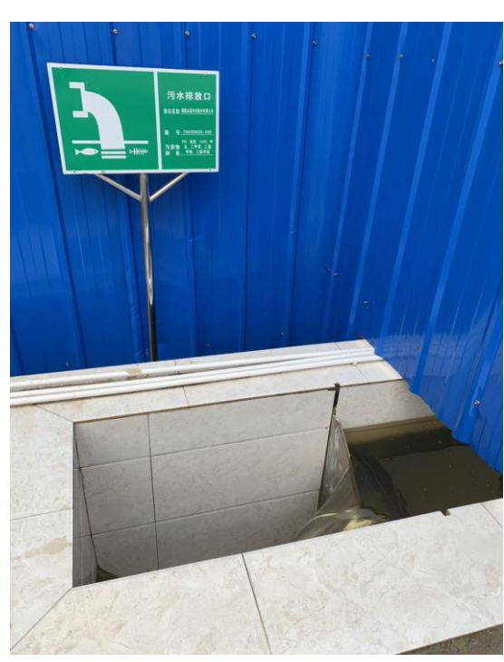
废水总排放口
