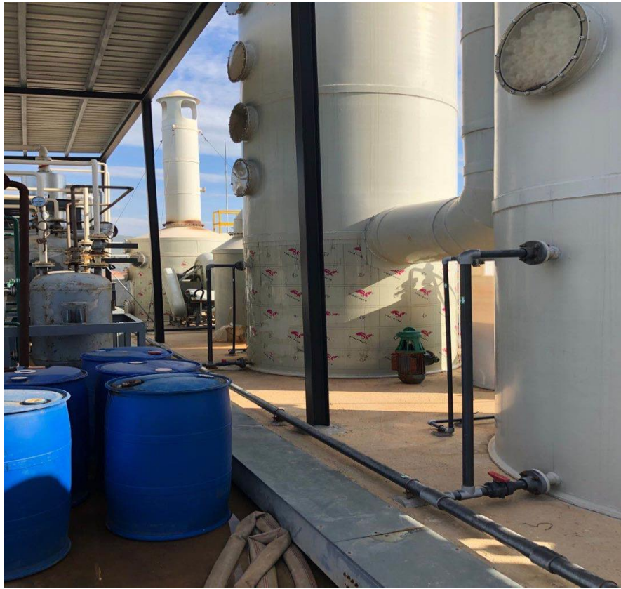
氟化 3 车间废气处理设施
