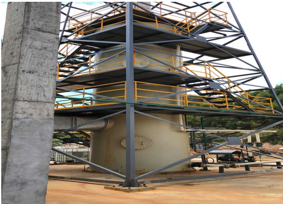
氟氮混合气车间钝化设备及设置空气置换废气处理设施
