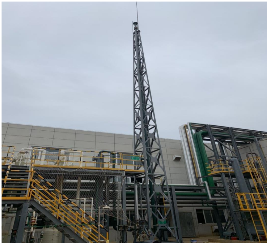
氟氮混合气车间电解产生的氢气尾气废气处理设施
