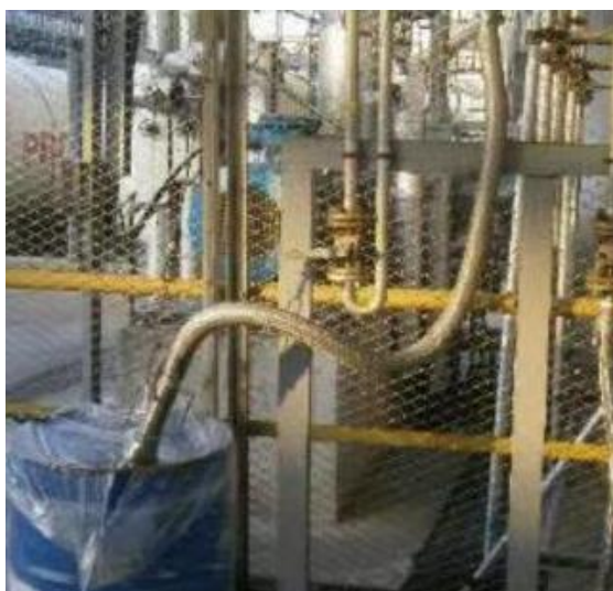
液体投加（密闭管道）
