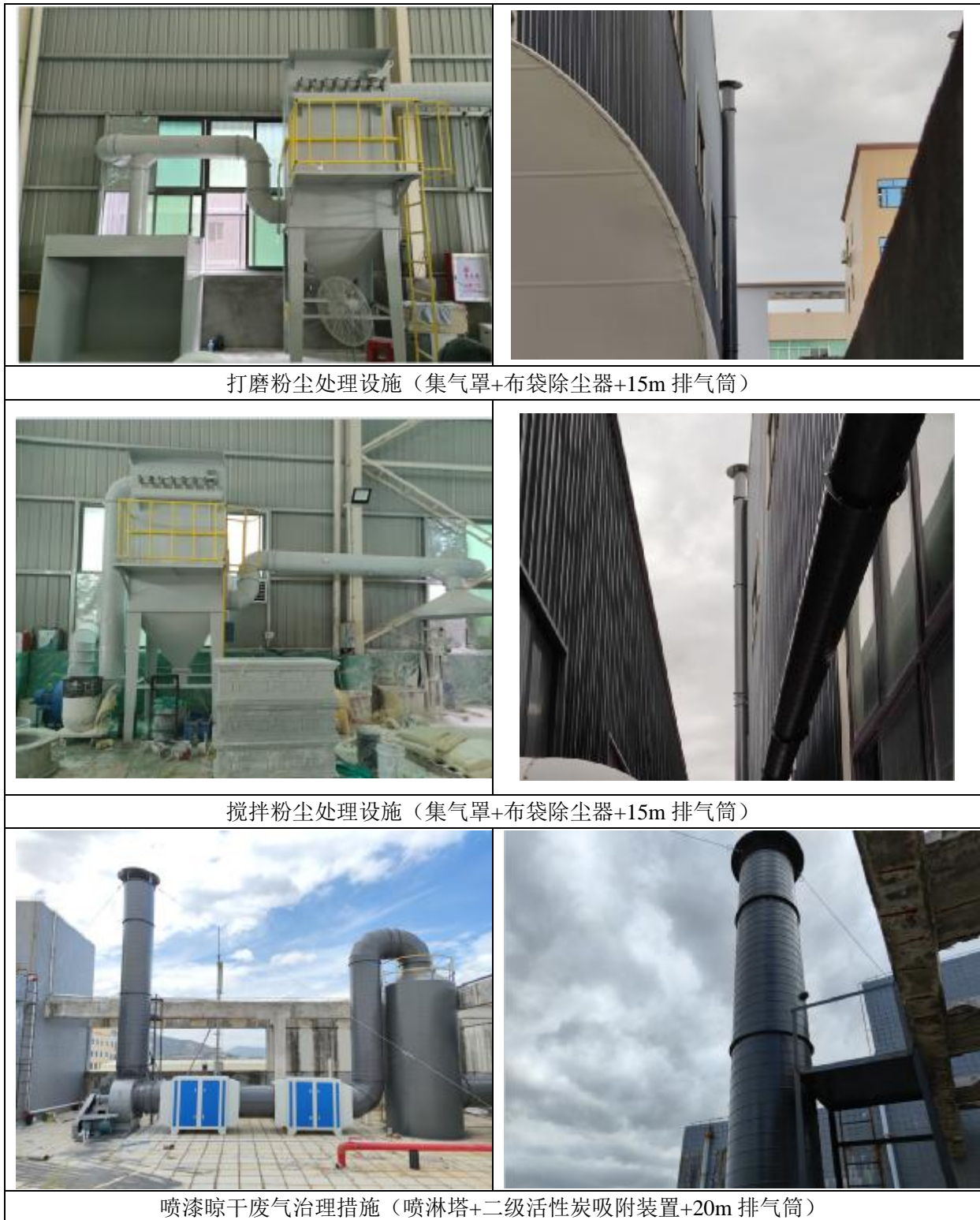
图 4-3 废气治理措施现状照片
