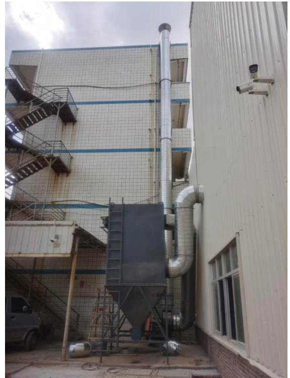
2#布袋除尘设施
