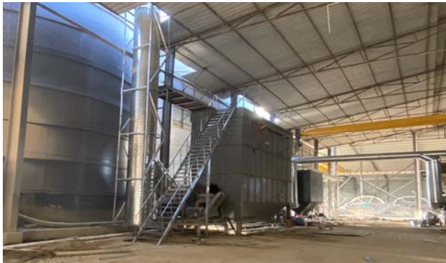
1#布袋除尘设施
