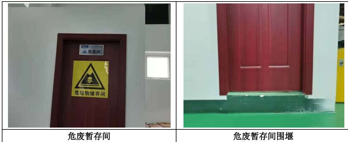
图 4.1-4 固体废物暂存设施照片
