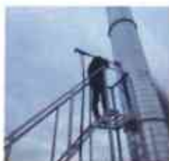
喷漆废气处理设施OP1 出口
