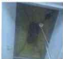
生产废水处理设施出口 ★W02
