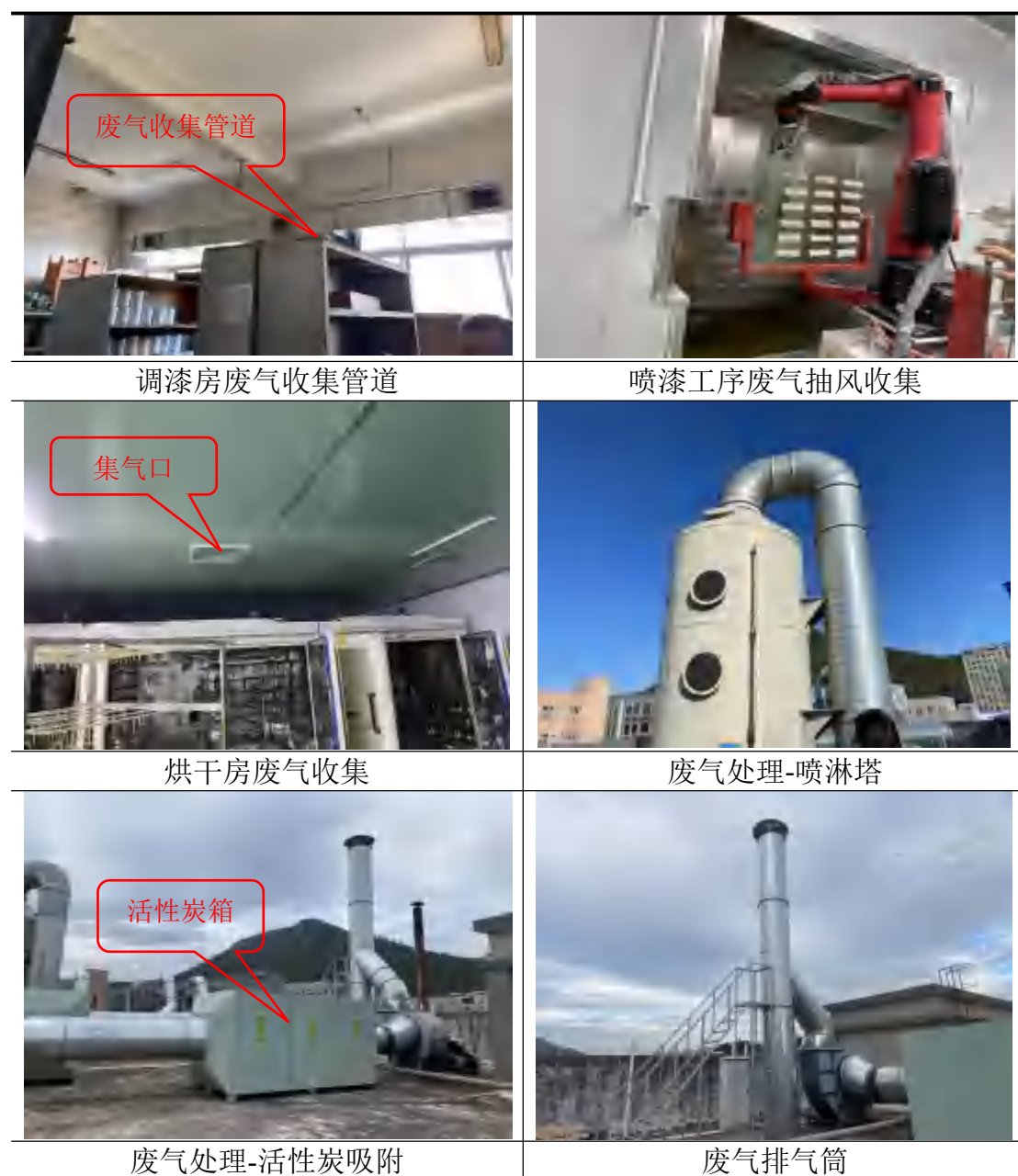
图 3.3-3 相关废气处理设施照片
