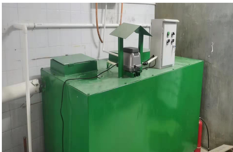
洗版废水处理设施
