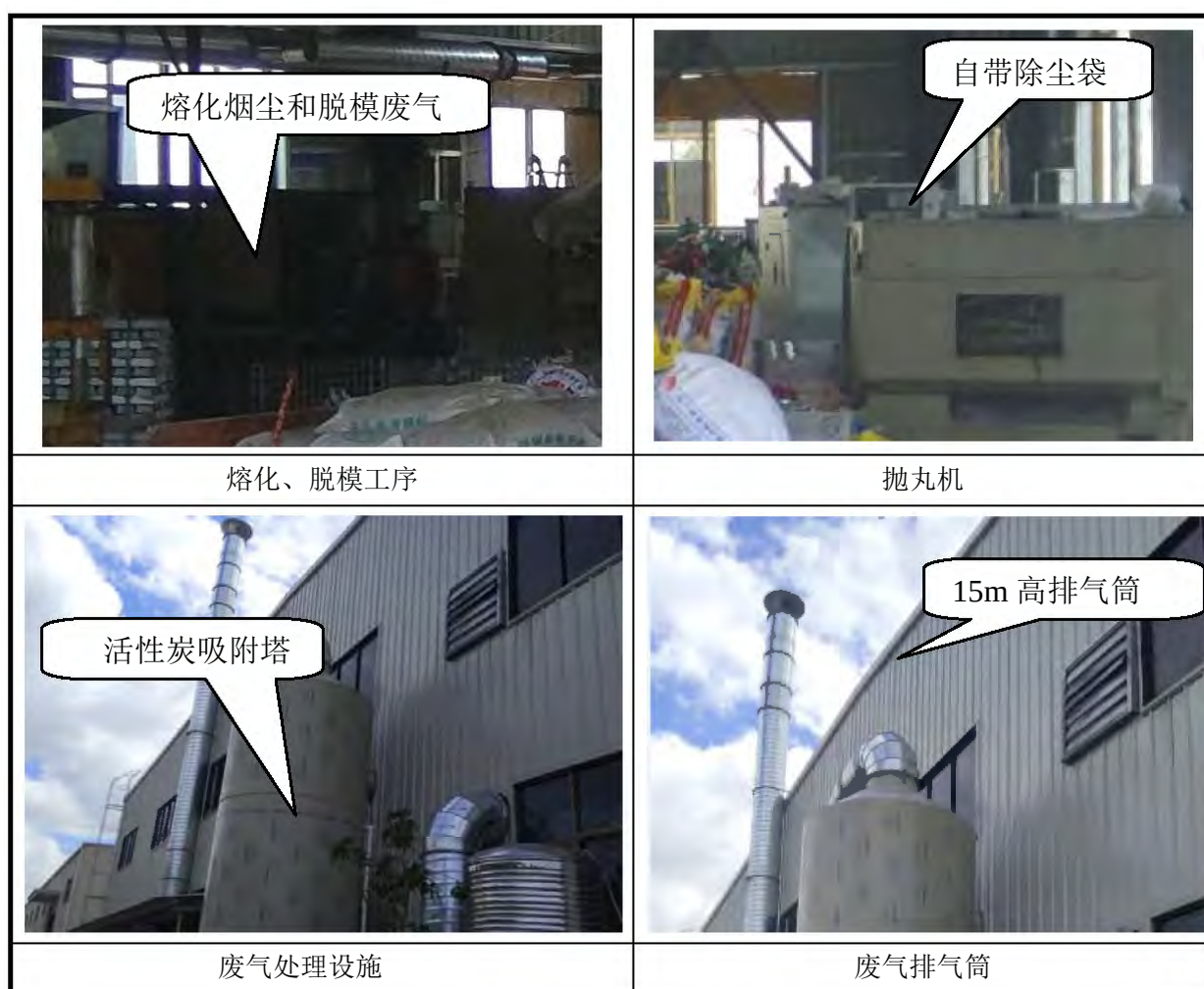
图 4-2 项目废气处理设施
