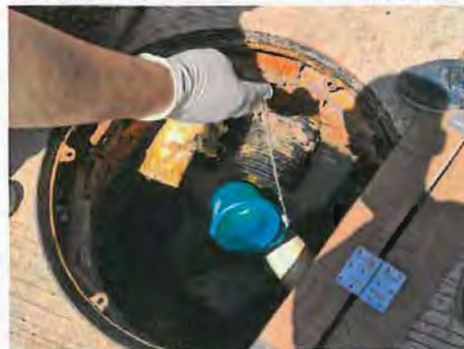
生活废水排放口 W1
