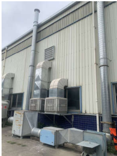
生产废气处置设施
