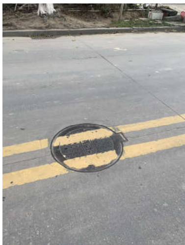
市政雨水排放口
