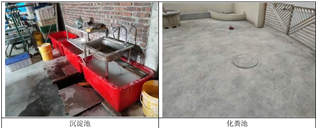
图4-2 污水处理设施现状照片
