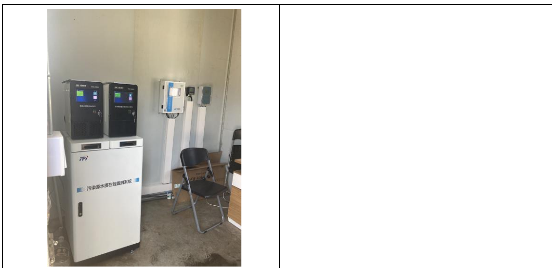
图 4.2-4 生产废水在线监测设施现场情况
