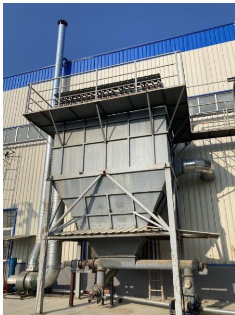
布袋除尘器+4#排气筒（15m）
