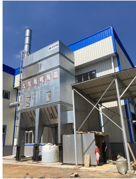
布袋除尘器+2#排气筒（15m）
