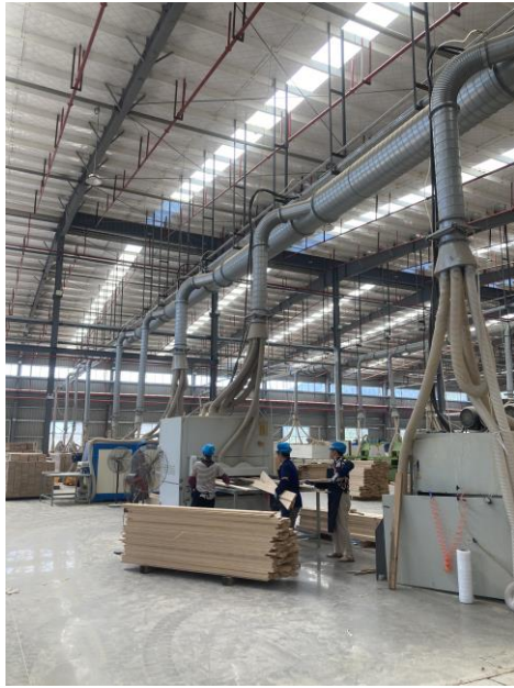
深加工区粉尘收集管道
