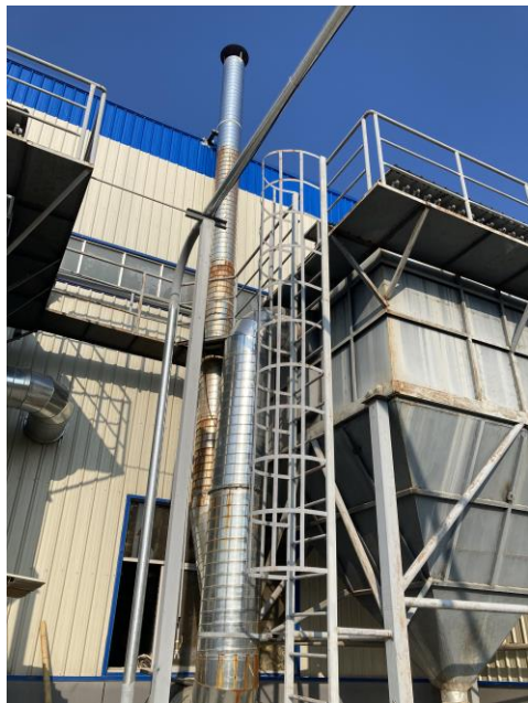
布袋除尘器+3#排气筒（15m）
