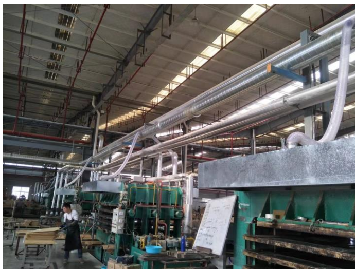
热压废气收集管道
