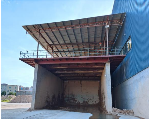
沉淀污泥暂存处
