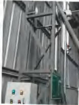
储油罐废气出口 G6
