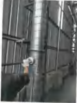
储油罐废气进口 G5
