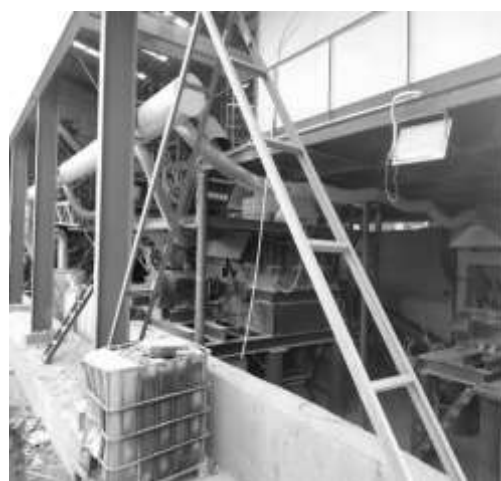
破碎粉尘集气罩+收集管道
