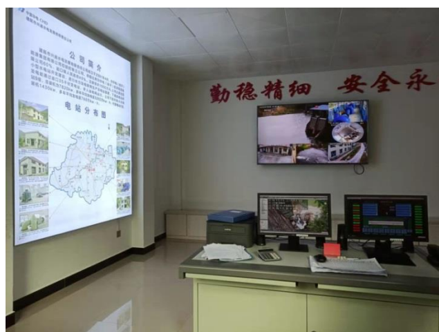
集控中心（下泄流量监控）
